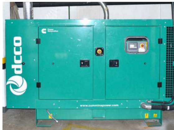
Instalação do Grupo Gerador em garagem subterrânea.
