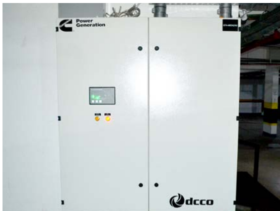
Quadro de transferência para monitoramento da energia da CELG e Gerador.
