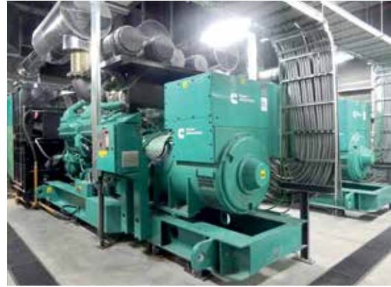
Grupo Gerador Cummins em funcionamento
