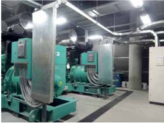
Parte do Grupo Gerador Cummins
