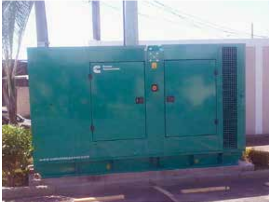
Grupo Gerador Cummins em pleno funcionamento no Grande Hotel Itaguaí.
