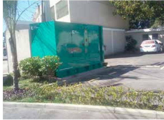
Devido à carenagem, o Grupo Gerador pôde ser instalado no jardim do hotel, sem maiores distúrbios à tranquilidade dos hóspedes.
