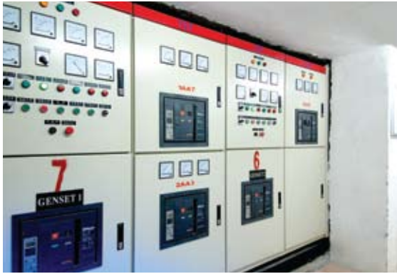
Usina formada pelos quatro Grupos Geradores e o Sistema de Controle, em pleno funcionamento.
