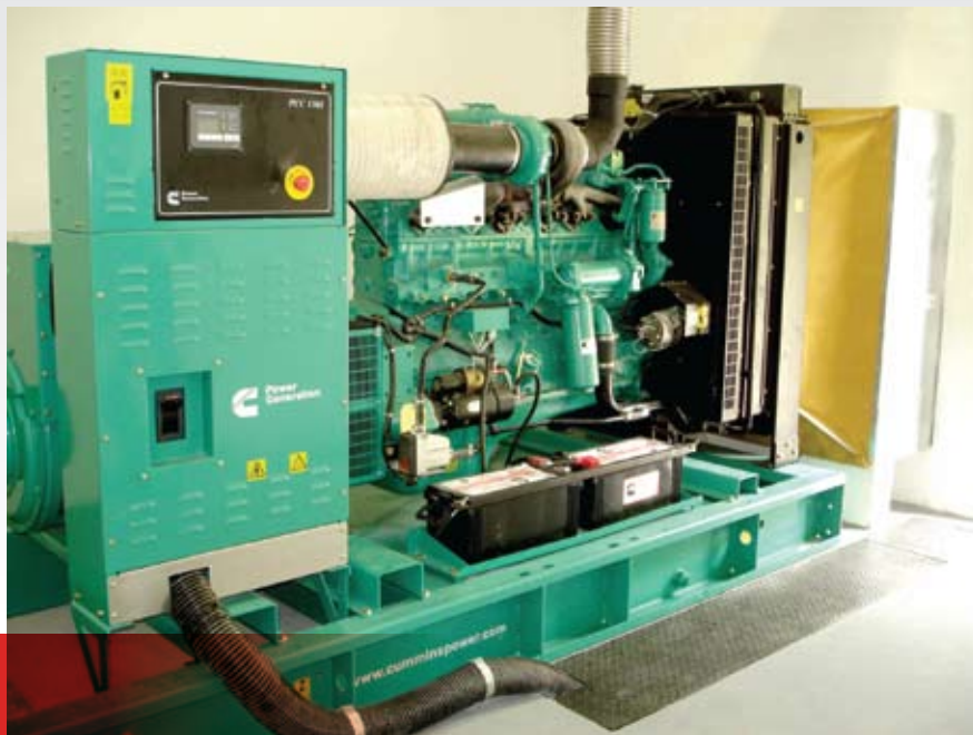
A instalação em sala apropriada, já com o modelo C240 D6 devidamente instalado e funcionando.
