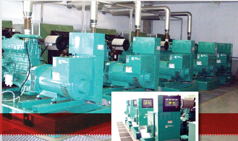
Ao lado, detalhes da instalação com os 5 Grupos Geradores Cummins modelo C400 D6, totalizando uma usina de 2280kVA.
