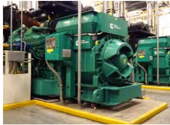
Grupo Gerador pronto para fornecer energia
