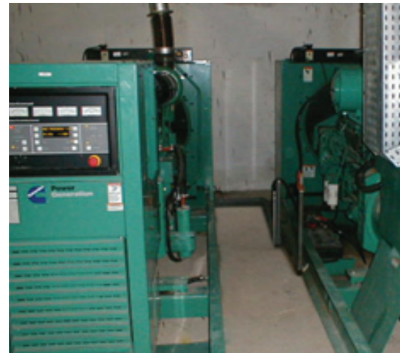
Os Grupos Geradores Cummins 350 DFCG.
